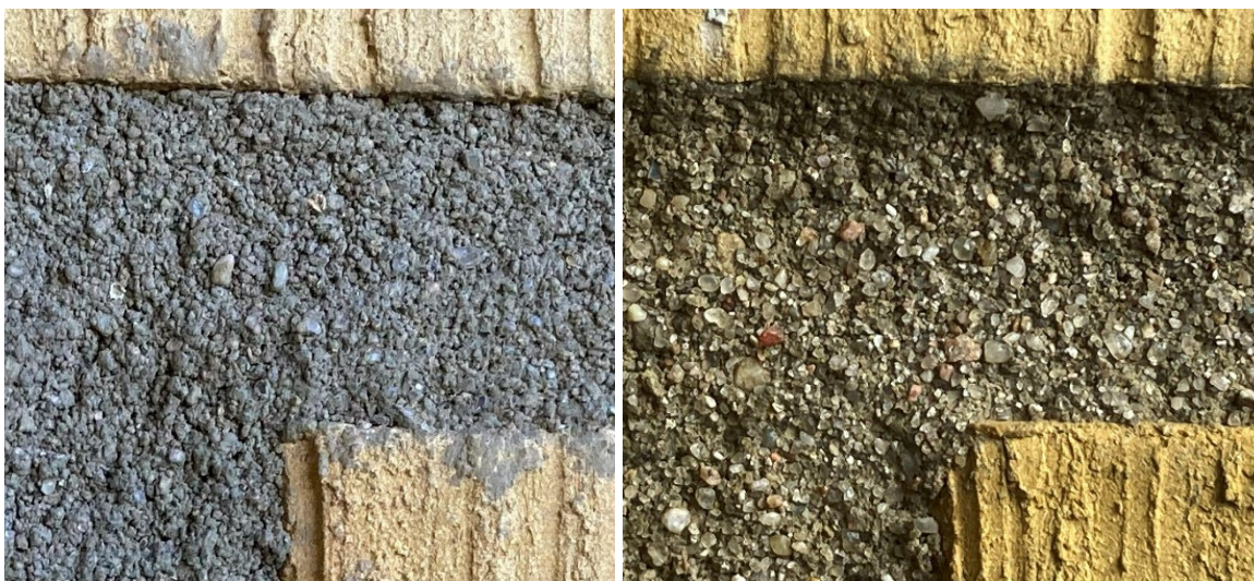
Figur 3.1 (Vänster) Närbild på murfog i skyddat läge, utan märkbar erosion; (Höger) Närbild på murfog i slagregnsutsatt läge i samma fasad. Frilagda sandkorn tyder på erosion (höger). Lund, byggnadsår 1965.
