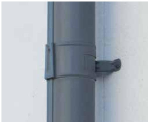
Infästning av stuprör med svep
