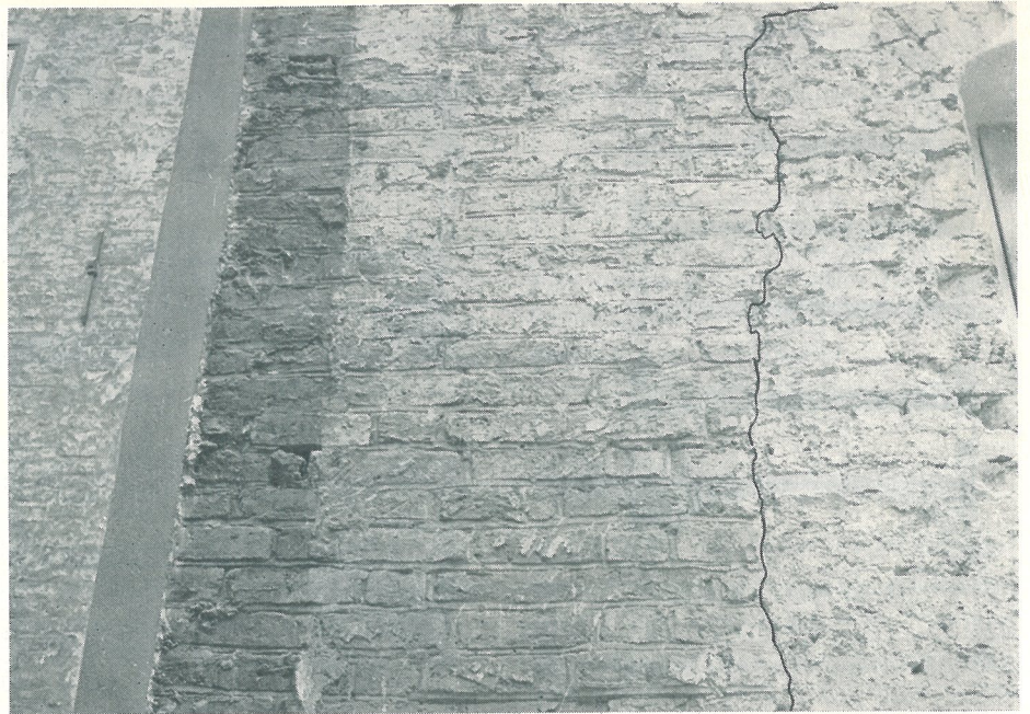
Medeltida murverk som framkom sedan putsen huggits ned. Den vackra fogstrukna ytan framträder väl mot senare inmurning till höger.
