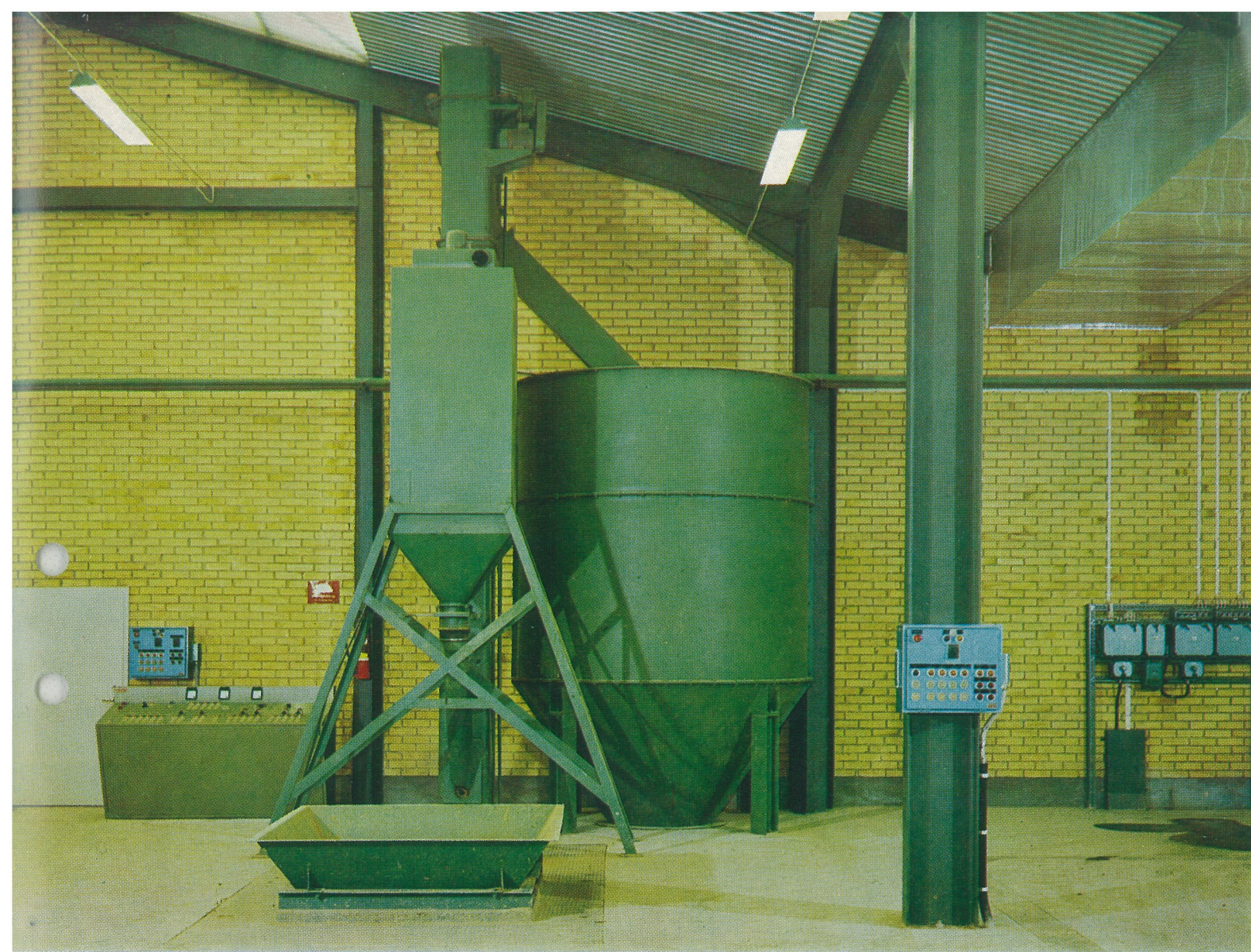
Mal- och siloanläggning vid Tjustorps Tegelbruks AB
