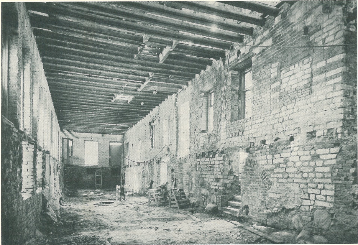
Genom att riva ut allt under senare tider uppbyggt "innanmåte" i huset fick man en bättre överblick över det antikvariskt värdefulla och kunde lättare skapa en funktionell rumsindelning vid restaureringen. Till höger syns ett medeltida murparti.
