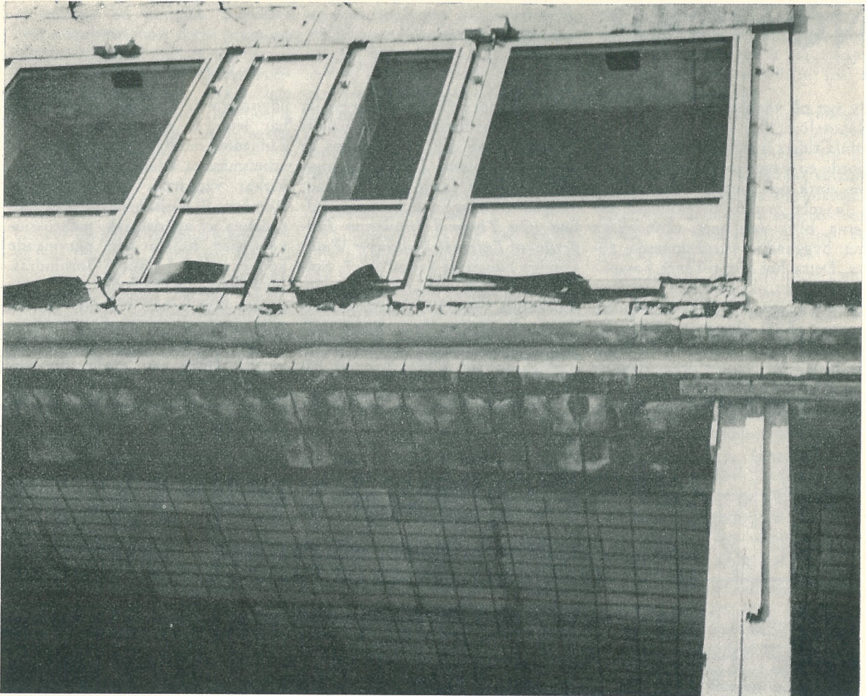
Fig. 13. Den tegelklädda kanten av arkadgångens tak. Saltutslagen som uppstått vid gjutningen av betongbjälklaget har ännu inte tvättats bort.
