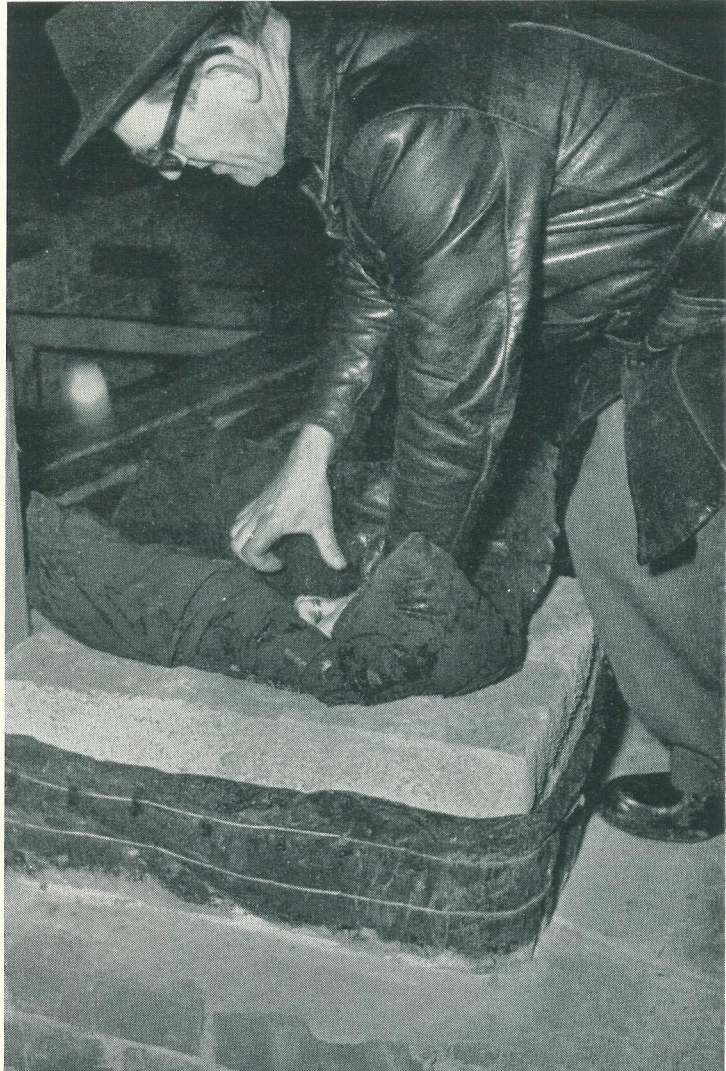
Bild 6. Ingenjör Åke Hedwall vid provtryckning av en röckanal. Lagg märke till byggfelet: mineralullsmattan som används som isolering mellan foder och mantel är sammanhållen med tjärpapp! Det skall givetvis vara trädnät.
