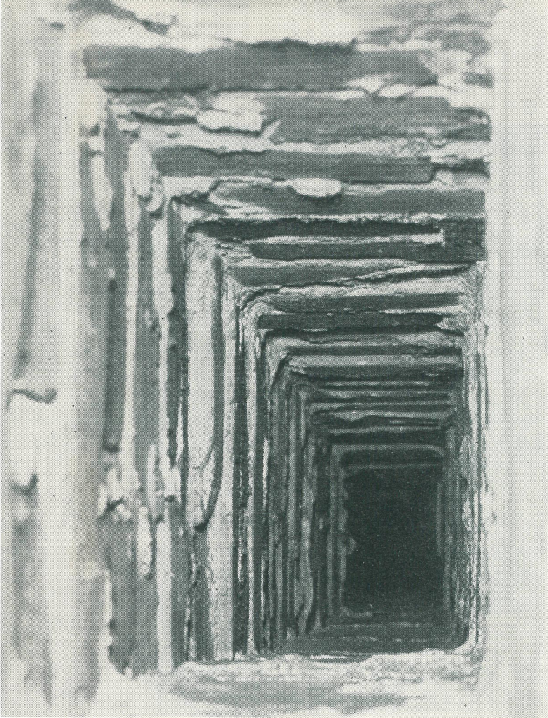
Bild 7. Så får det inte se ut! Såväl rökkanaler som ventilationskanaler skall vara jämna och släta invändigt. Utskjutande brukstuggor skall skäras bort med skärseven. Kanalen bör sedan strykas med en mjuk borste doppad i bruksvälling eller strykas till med rörspade och säcktorkas.
