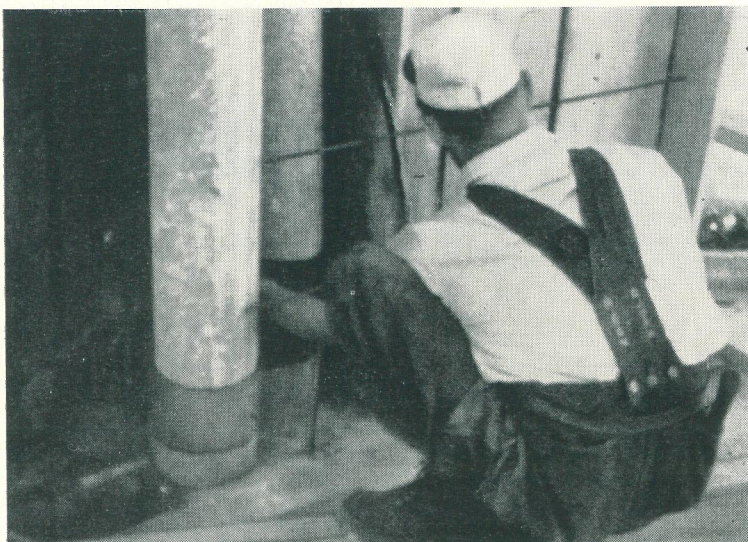
Bild 5. På samma bygge där ventilationskanalerna på bild 3 och 4 murades så slarvigt, tätade man rörkanaler så här omsorgsfullt vid skarvarna där bjälklagsplattan skulle gutas.
