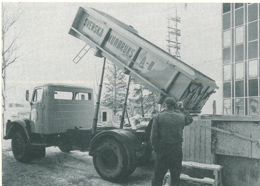
Snabba och effektiva murbrukstransporter är en av förutsättningarna för att sprutputsningen skall komma fullt till sin rätt. Ett effektivt transportredskap är denna nya högtippande bil.
