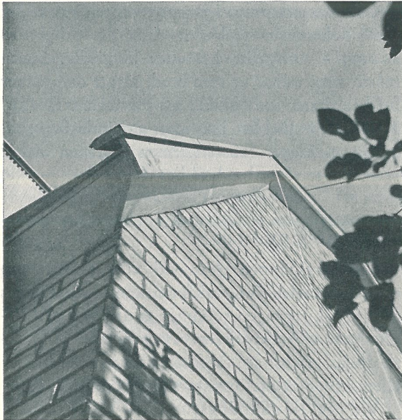
Fig. 11. Här har tegelbeklädnaden avslutats mot taket genom avrappning, som sedan täckts med en bräda.
