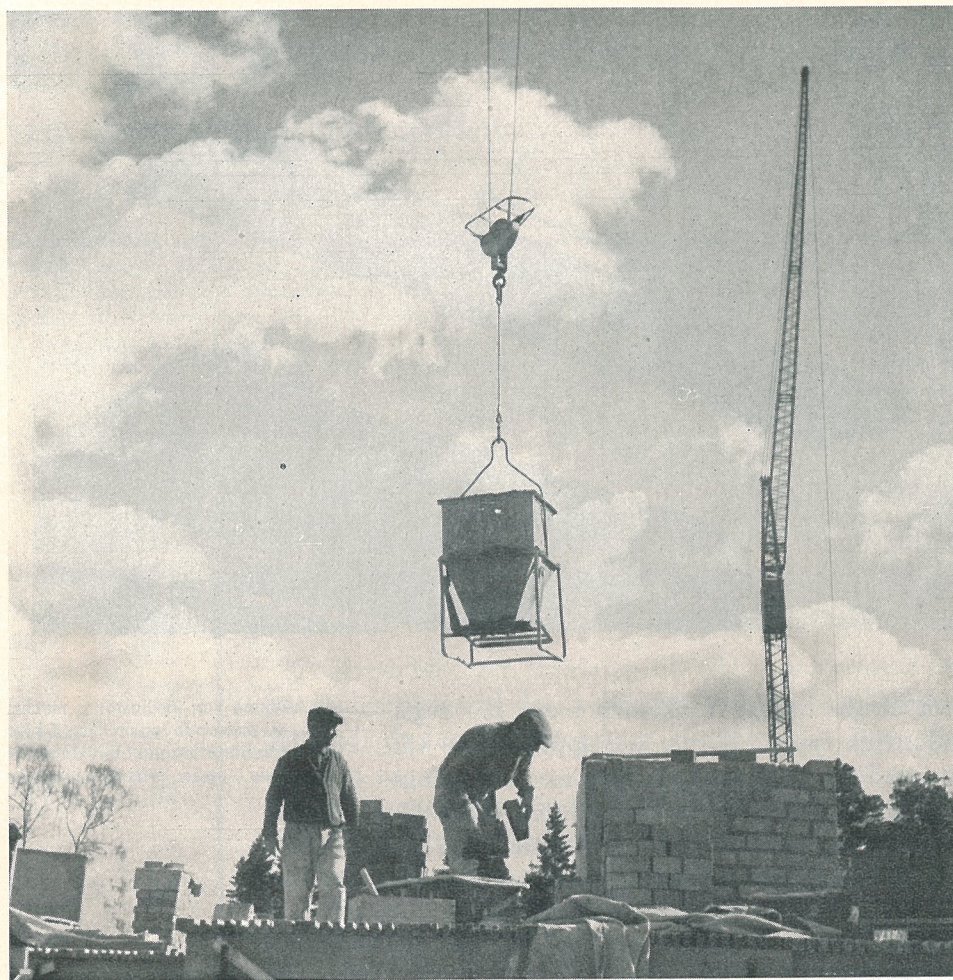
Materialtransporterna på byggena i Hagsätra sker med kran. Byggnadsplatsens planering är väl genomtänkt, och transporterna sker smidigt och i rätt ögonblick. Genom att teglet är pallat får man ordning och reda på arbetsplatsen och arbetet flyter lättare.
