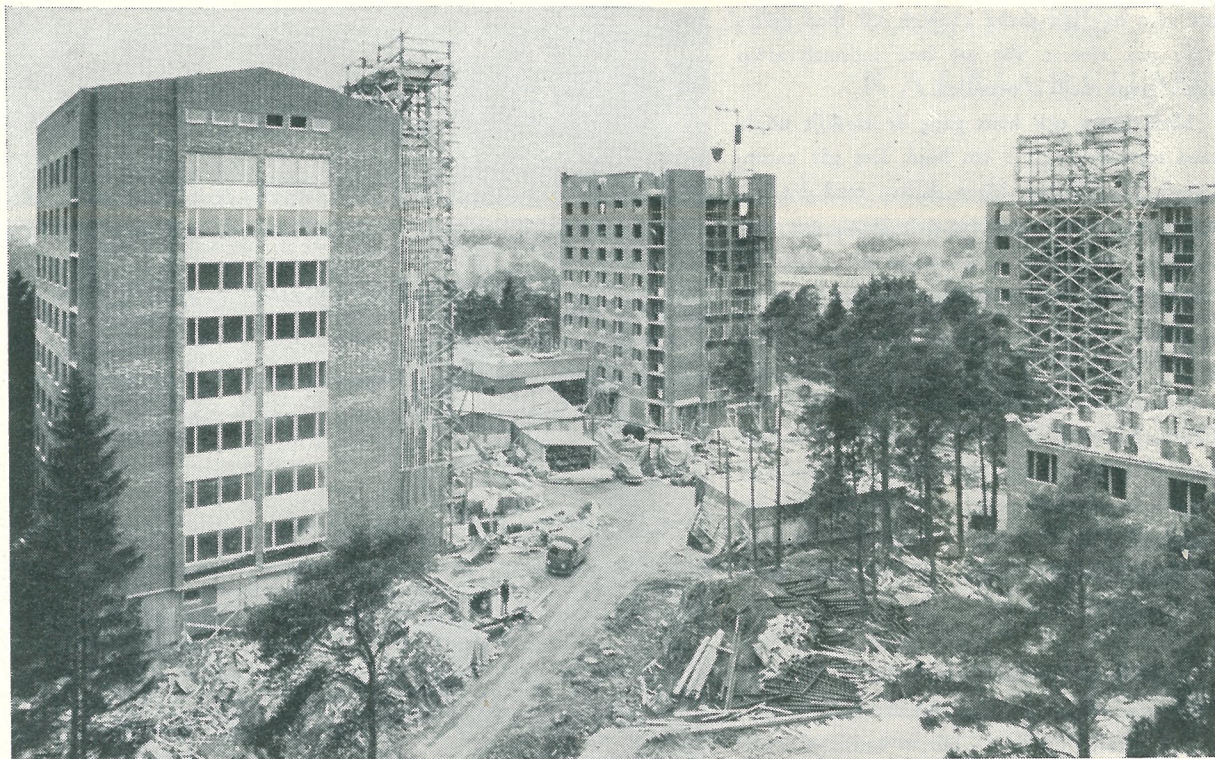
Del av kv. Rådsbacken under byggnadstiden. De färdiga husen syns i färg på omslagsbilden.
