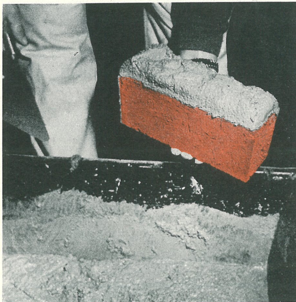
För att undvika att smutsa ned tummen kan muraren gripa stenen över löpytan såsom bilden visar. Vid läggningen får han då släppa ner stenen i bruksbädden samtidigt som han skjuter in den mot stötfogen. Detta innebär någon ändring av gängse murningsteknik men är dock fullt genomförbart.
