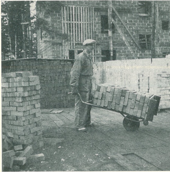
Fig. 3. Materialtransport i Stockholm. Teglet ordnades i paket och ställdes på pallar på upplagsplatsen. På tegelkärror kördes det ut till murarnas arbetsplatser direkt på murarställningarna. Någon särskild omlastning var således ej erforderlig uppe på bygget. På liknande sätt transporterades bruket, som alltså också kördes direkt på ställningarna i brukskärror.
