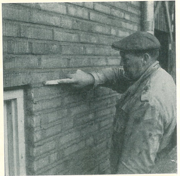
Fig. 11. Fogning av fasad i Malmö. I Malmö syrades och fogades fasaden från utvändigt fasadställning sedan stommen var uppmurad. Man ansåg sig därmed erhålla bättre fyllda och jämnare fogar. Samma arbetsföljad användes i Göteborg.
