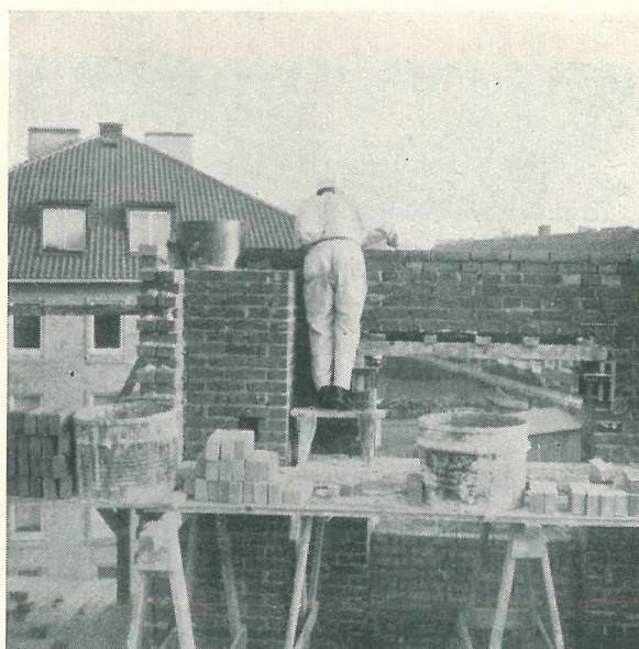
Fig. 9. Murning från ställning i Malmö. Om muraren var liten till växten kunde det vara svårt att nå, när han på överstöten skulle kratsa ur fogarna. Med en liten bock avhjälpes dock denna svårighet på ett enkelt sätt.
