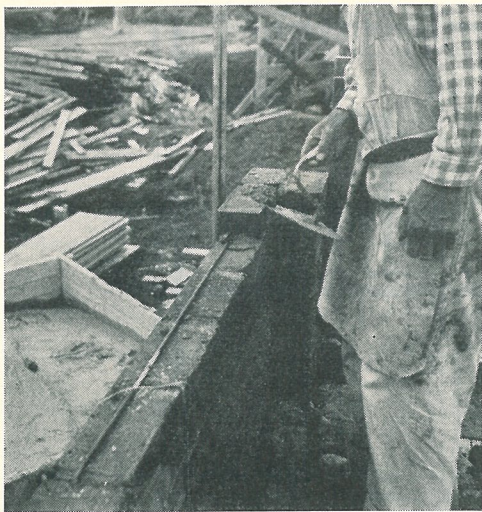
T. v.: Skalmursväggarna armerades mot vindtryck i vart tredje skift med \varnothing 8
