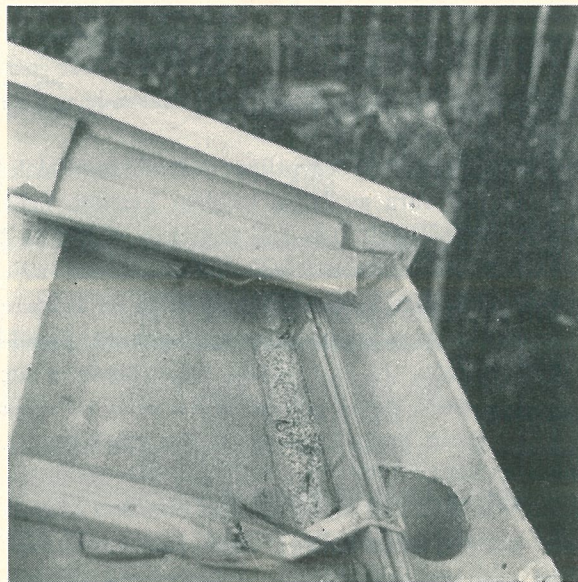
Fig. 11. Fel! Den tvärställda brädan hindrar vattenavrinningen
