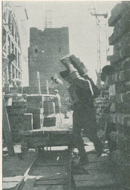
Ovan: Takstolarna resas över östra långbyggnaden — Murning av sydvästra hörnpartiet. Teglet körrades fram till tegelbärarna på decavillespår från pråmarna vid kajen på Norr Mälarstrand
