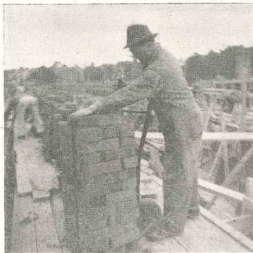
Fig. 11. Paketet framkärnat till plats å ställningslaget. Här efter sker avbandning av paketet.
