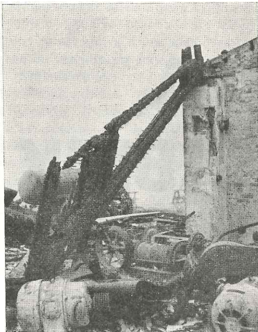
Totalförlust av värdefulla motorer och maskiner. Den förkolnade träkonstruktionen bibehåller sin ursprungliga form.
