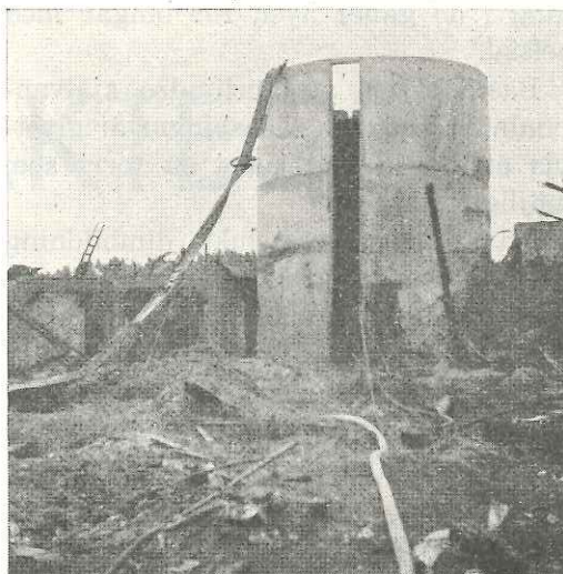
Tegel- och betongkonstruktionerna så gott som oskadade. Totalskada för järn- och träkonstruktionerna.
