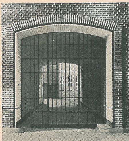
Fig. 19. Povl Baumann: Port mot Larslejstraede i egendomen Nørrevold 32—34. Fasaden har fogats med Hamburgerfogor. Den djupliggande smygen mellan den fogade portomfatningen och den vitmålade ytan är struken med svart oljefärg. Portens sockelmur har behandlats på samma sätt.
