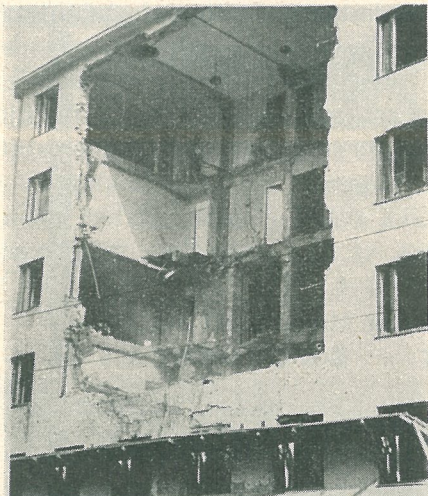
Fig. 5. Tegelbyggnad med inre stomme av betong träffad av 100 kg:s minbomb. En del av fasaden här tryckts ut och bjälklagen störtat in. Då bilden togs ha dessa röjts bort. Öväntat liten skadegörelse. (Helsingfors). (Luftskyddsinspektionens bildkompendium.)
