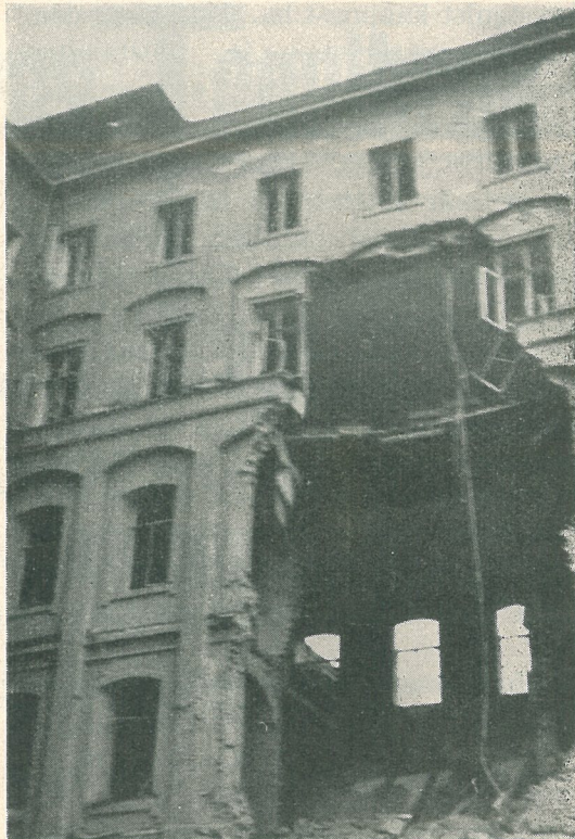
Fig. 7. Tegelbyggnad, den inre stommen är av tegel, och efter vad som kan synas bjälklagen av betong. Hur stor bomben varit kan ej anges, men torde väl röra sig om 100 kg:s minbomb om man jämför skadegörelsen med fig. 5 och 6. Observera lampan, som hänger kvar i taket. (Finland). (Obekant fotograf.)
