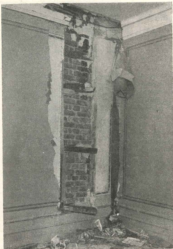
Fig. 6. Skorsten med inmurade spikreglar av trä. Eldsvåda i Djursholm, jan. 1942.
