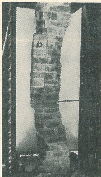
Fig. 6. Chicago- pelare vid brott. Be- lastning 140 kg/cm 2 . Armering med längs- gående järn och ringar.
