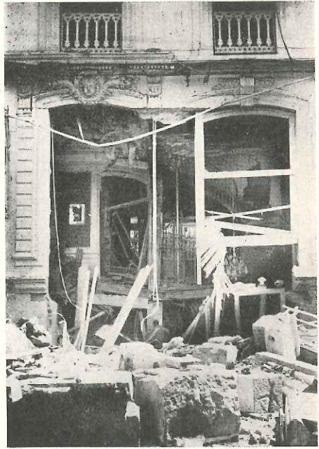
Fig. 6. En intressant bild, som visar, hur ett tegelmurverk efter en totalskada på en pelare dock har stått kvar. Här är det även så ogynnsamt, att vi mitt på öppningen, som uppstått, har en punktlast. Det kan inte vara ogynnsammare.
